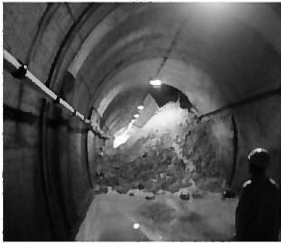
平成23年8月21日に発生した天井部崩落直後の様子
