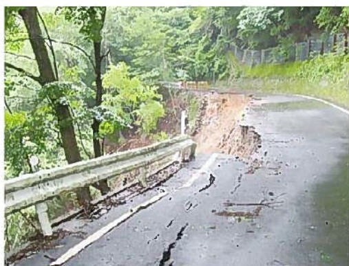
県道津具大嵐停車場線（猪古里～津具 路肩決壊）
