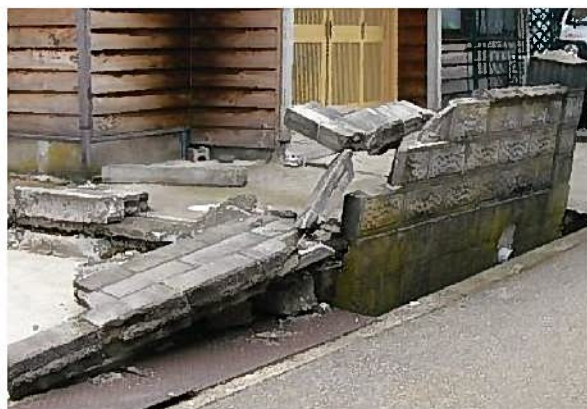
写真 「平成 19 年能登半島地震」 で傾いたブロック塀
